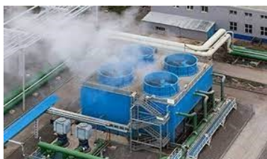
TOURS DE REFROIDISSEMENT
